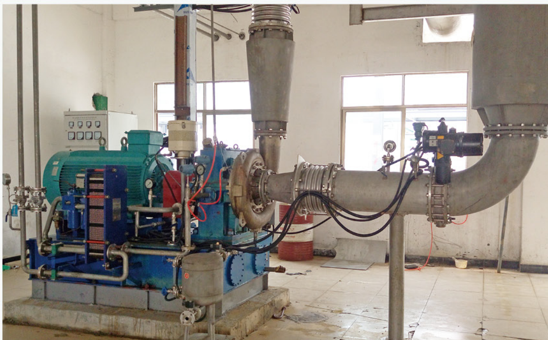
佛山市德方纳米科技有限公司(LEP尾气回收装置项目硝酸气体)
