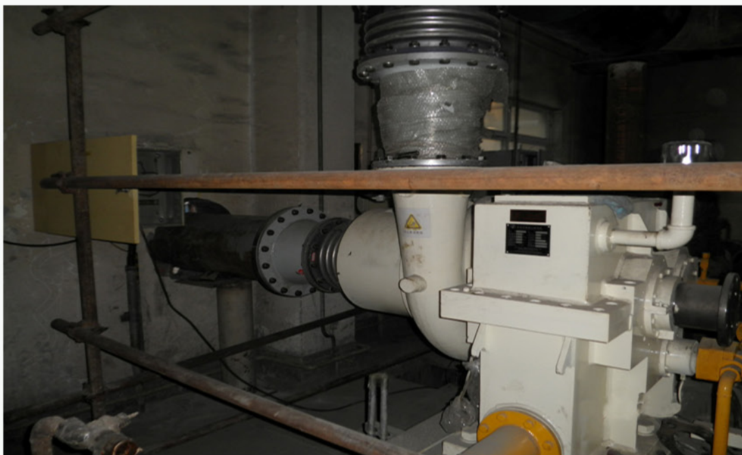
磴口华润金牛煤电 2 \times 300 \text{ MW} 机组脱硫改造项目
